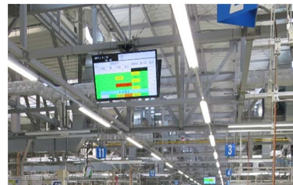
稼動監視システム導入による生産性向上
