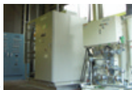
田戸岬工場 オゾン発生装置
