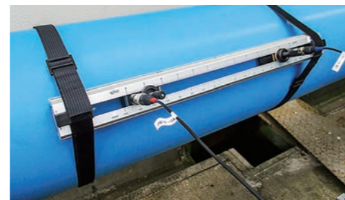
超音波流量計による冷却水の流量測定
