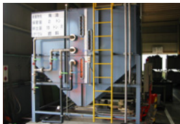
油水分離タンク
