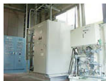
オゾン発生装置
