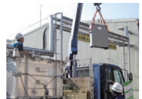
PCB機器処理状況(東京工場)
