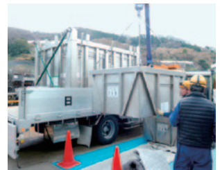
PCB機器処理状況(国分工場)
