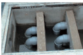
油水分離装置
