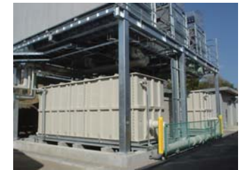
夜間蓄熱式空調システムの写真 下部が蓄熱槽、上部がヒートポンプ
