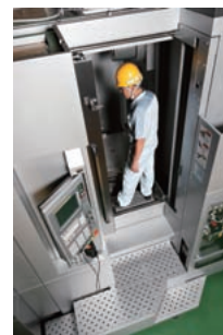
主操作盤と接近性の良い操作扉
